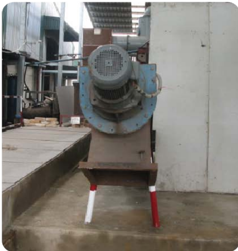
Hệ thống thu hồi tro
